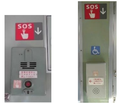
非常通報装置 1 非常通報装置 2
