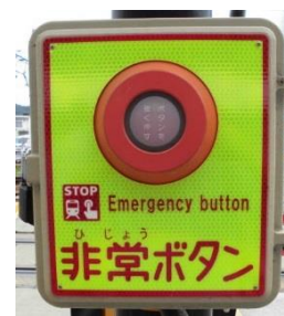
踏切支障報知装置
